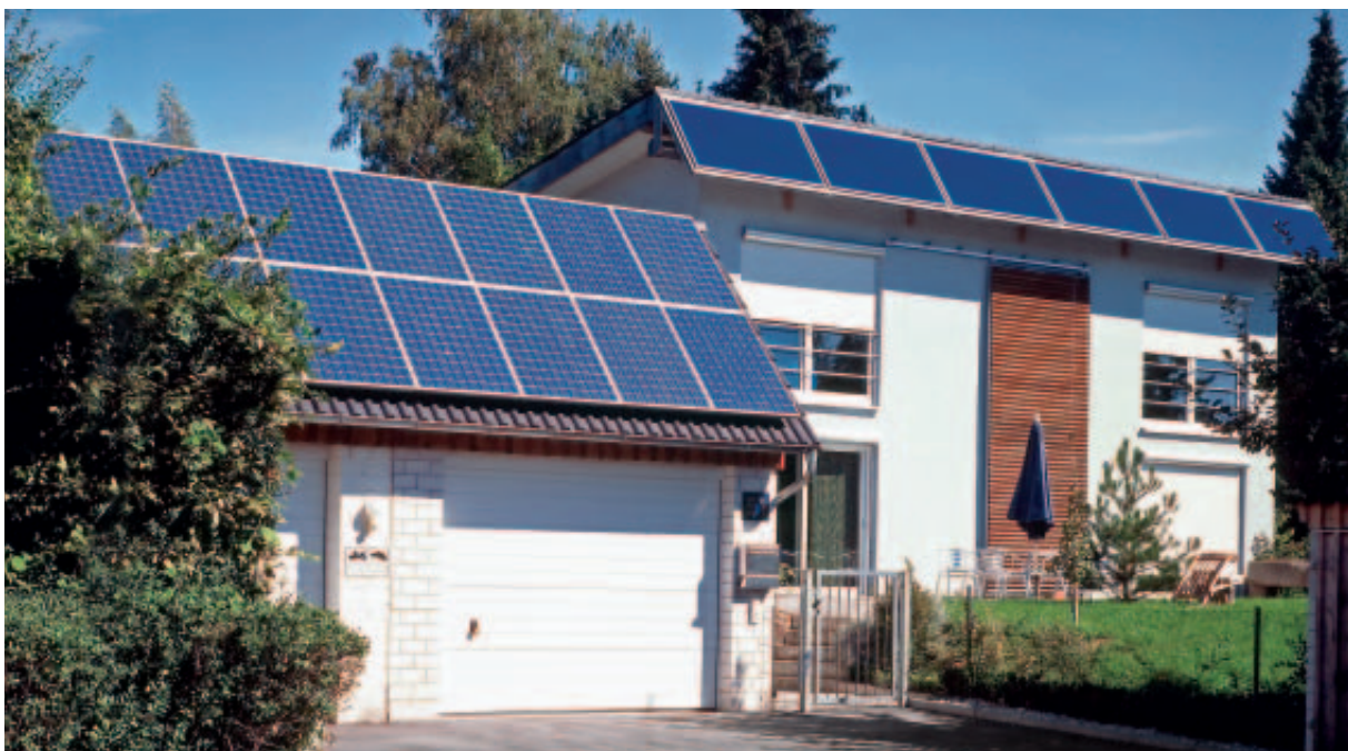
Garage mit Aufdachmontage
